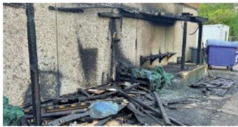
Der Hof der Olvenstedter Tafel: Hier hatte eine Mülltonne gebrannt und Schäden an der Ausgabestelle angerichtet.
